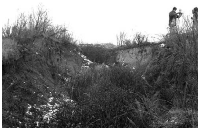
Рис. 3. Характерные разрушения части грунтовой плотины
