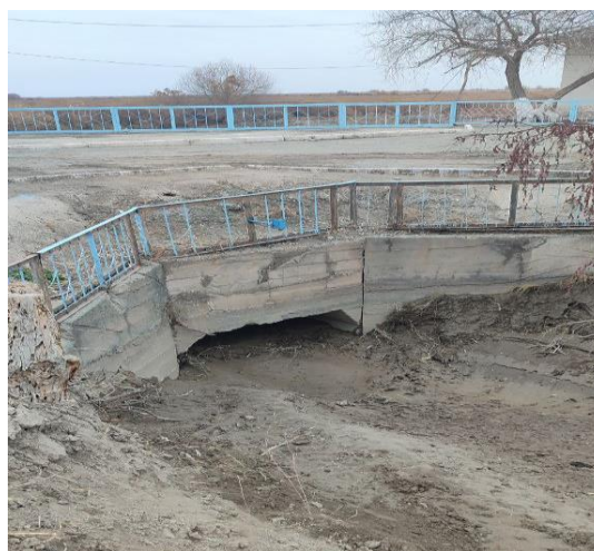
Заиление канала перед сооружением
