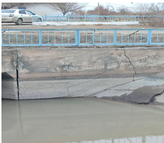
Образование трещин в сооружении канала
