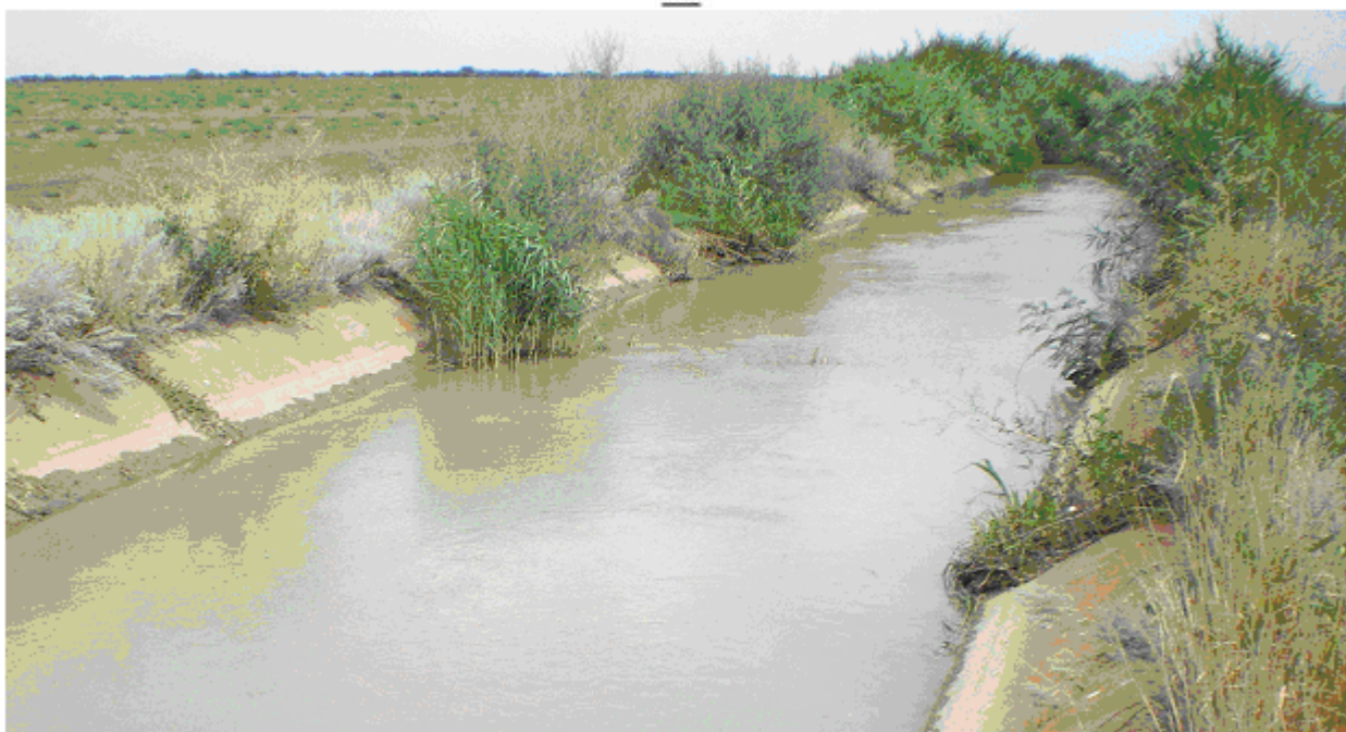
Рисунок 1 Заращение сорной растительностью бетонного русла канала (Дивенский распределитель в Ставропольском крае)
