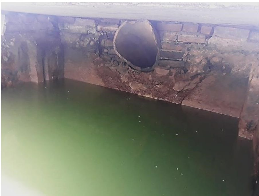
Рисунок 1 – Отводящая (переливная) труба дренажного колодца (ООО «Золотовское», Семикаракорский район Ростовской области) (фото Т. И. Дровозовой)
