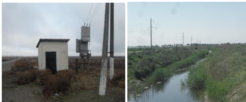
Рисунок 1 – Техническое состояние СВД и открытого коллектора в Махтааральском массиве орошения
