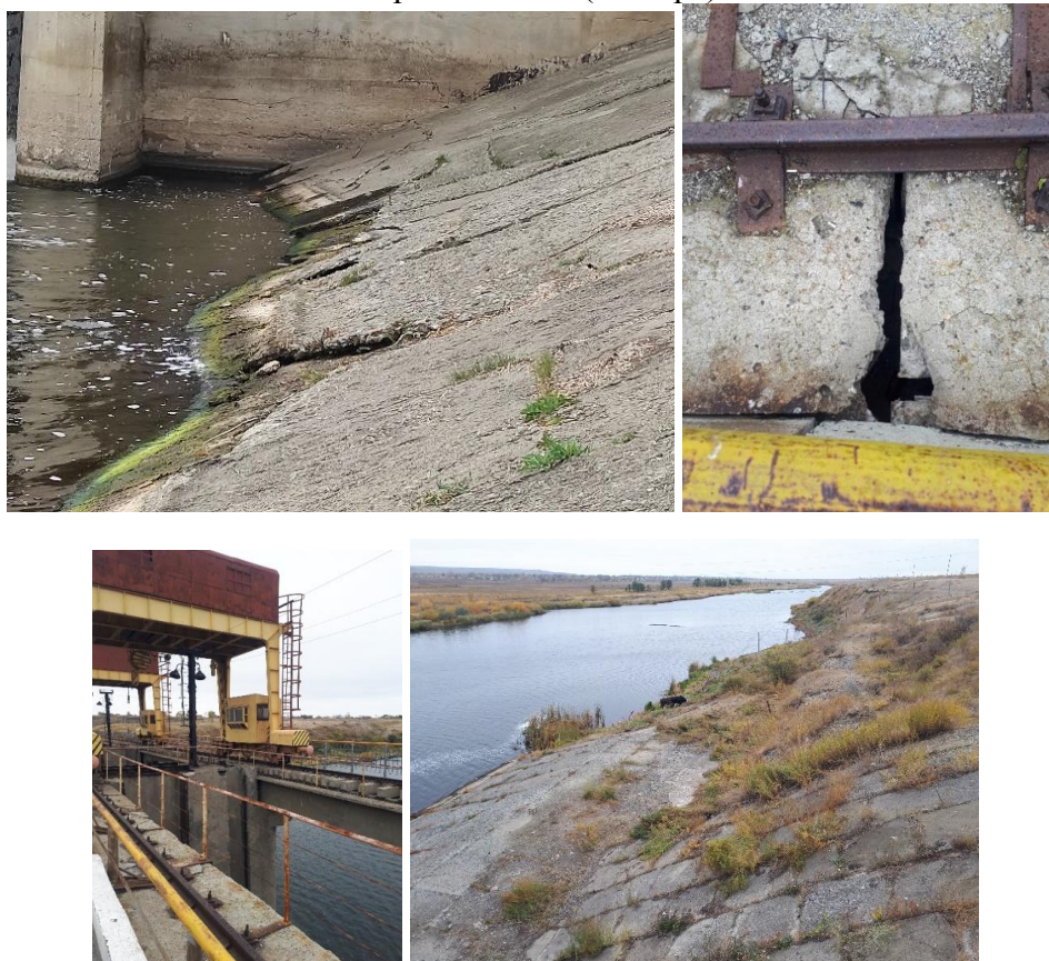
Рисунок 2 – Недостатки технического состояния сооружений и конструкций водохранилищ
