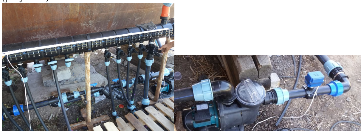
Рисунок 2- Фильтр тонкой очистки и напорная труба с насосом
