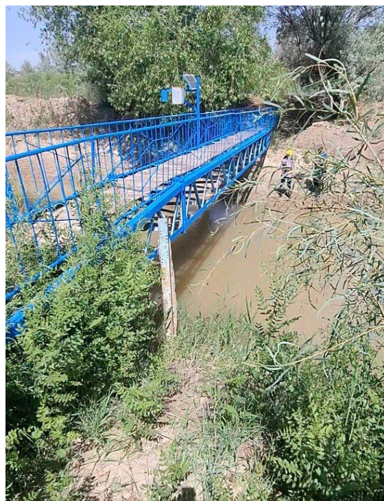
Гидропост на канале «Судочье»
