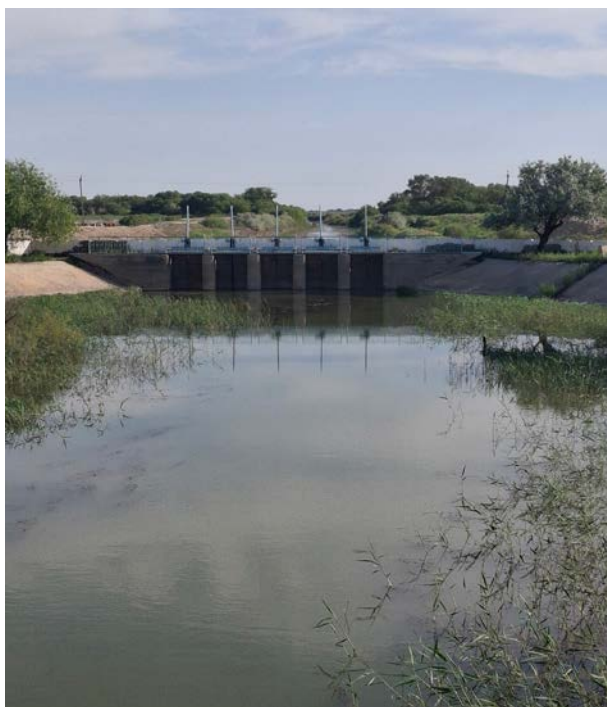
Головное сооружение канала Муйнак, пропускная способность 44,2 м 3 /с.
