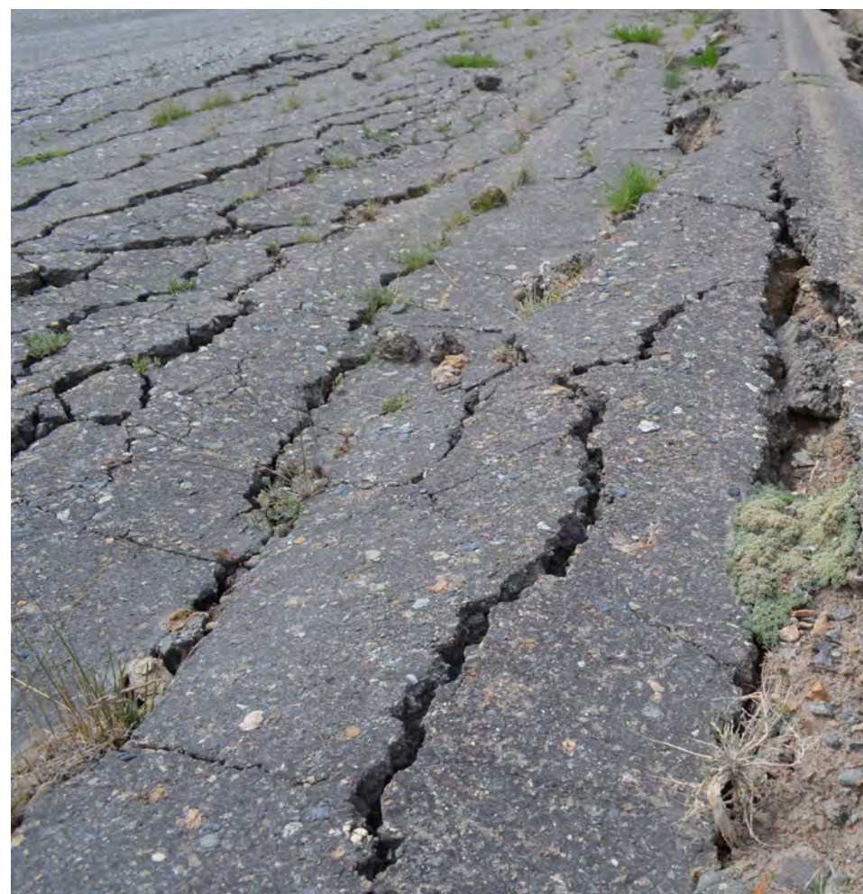
Трещины в асфальте на старом Памирском шоссе в Таджикистане
