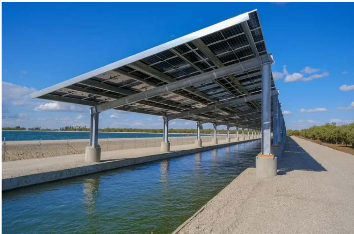
Солнечные панели над каналом: вид снизу
