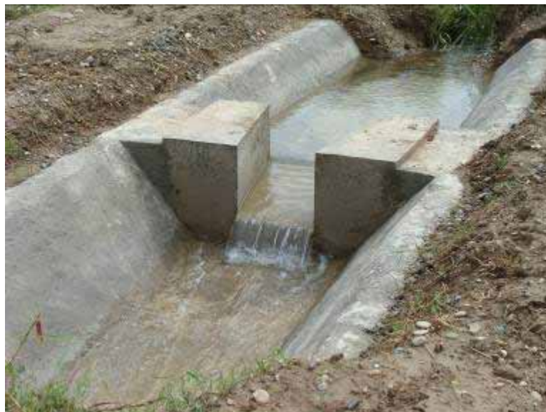
Рис. 6. Гидропост с ВЛС, вид с нижнего бьефа
