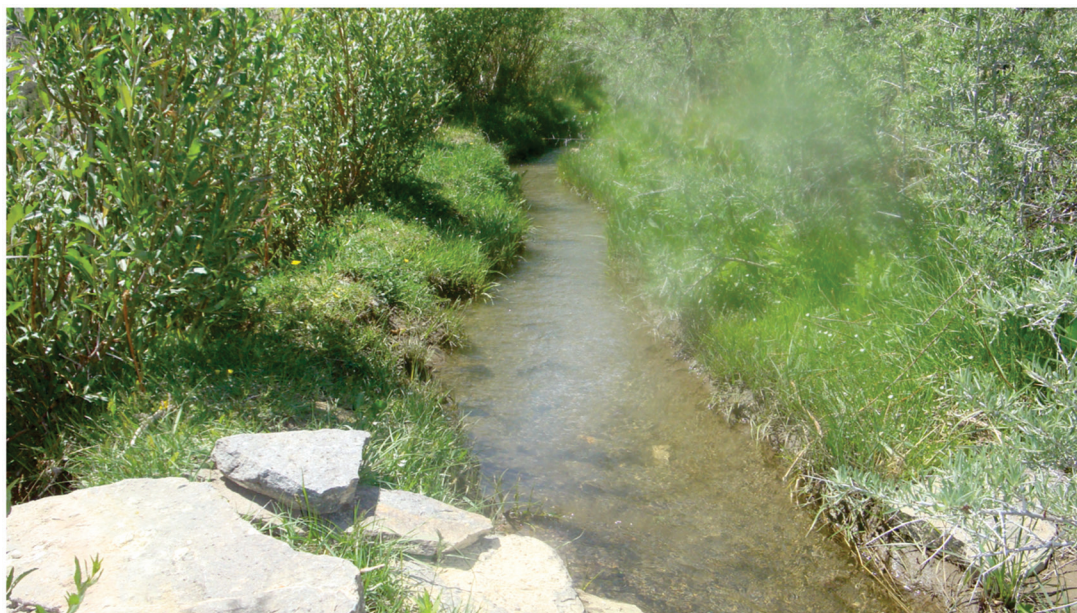
Рис.3. Проложенный без гидроизоляции земляной канал Вездара-Миденвед, который является главным фактором образования техногенного оползня. Автор фотографии Шафиев Г. В.
