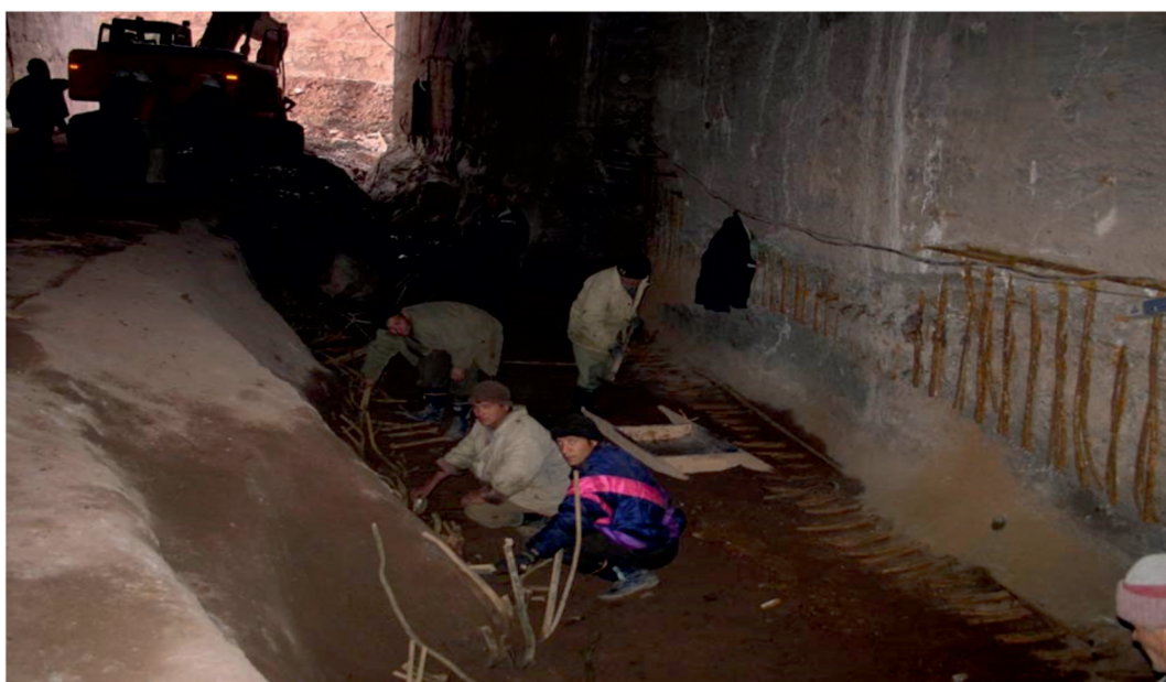
Рисунок 1. Размыв лотка I-го строительного туннеля
